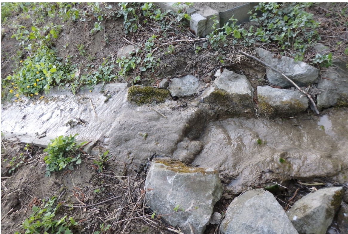
Spodní část otevřené trsy dešťové kanalizace, zpevněná betonem
