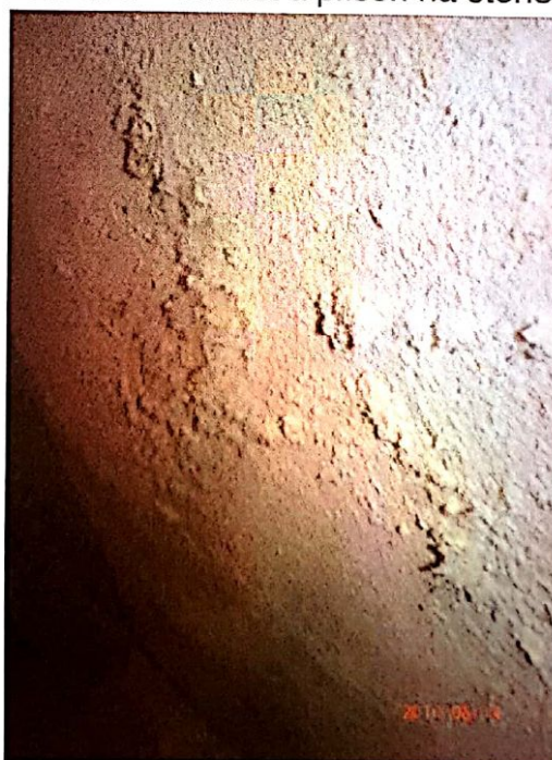
Foto č. 9 – vlhkost a plíseň na stěně
