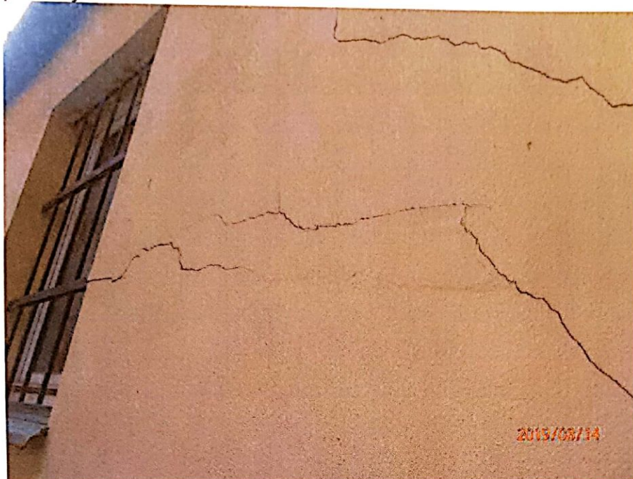
Foto č. 3 – trhliny na vnější fasádě se projevují přes několik zapravení a to i s použitím perlinky
