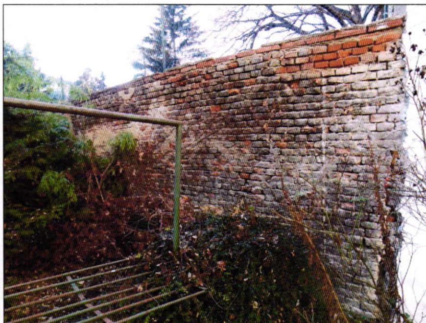
Foto č. 4 – Pohled na zeď ze zahrady sousedního domu Jaselská 13.
