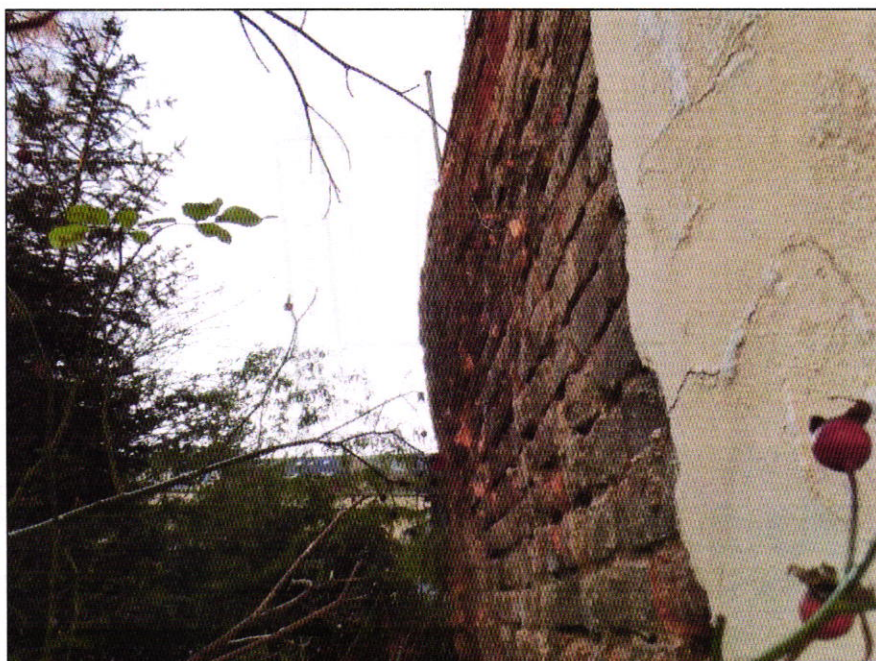
Foto č. 6 – Deformace a náklon zdi ze strany zahrady domu Jaselská 13.
