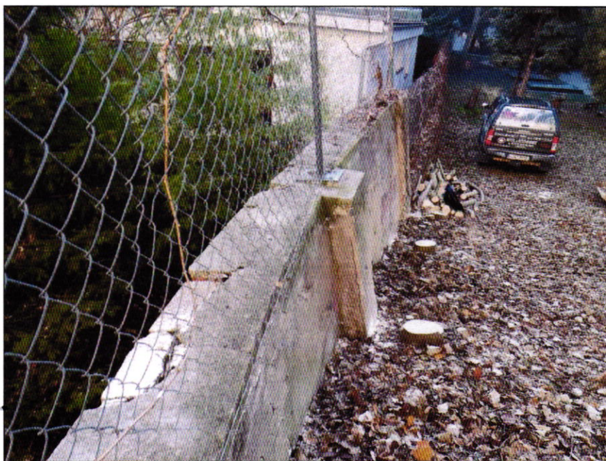
Foto č. 3 – Deformace zdi do oblouku a také narušená betonová koruna zdi.
