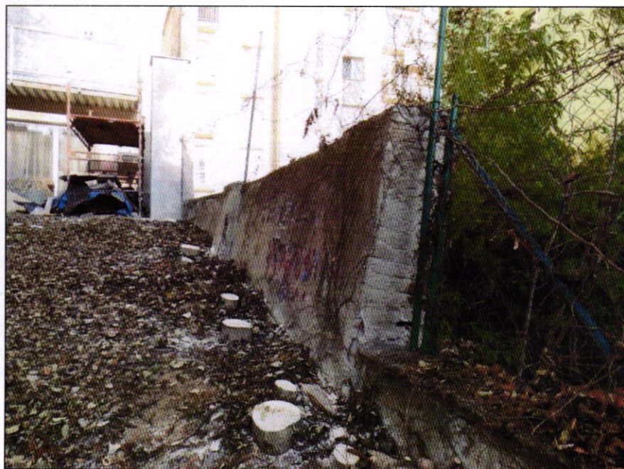
Foto č. 2 – Pohled, na kterém je vidět naklonění zdi a také pařezy po vykácených dřevinách.
