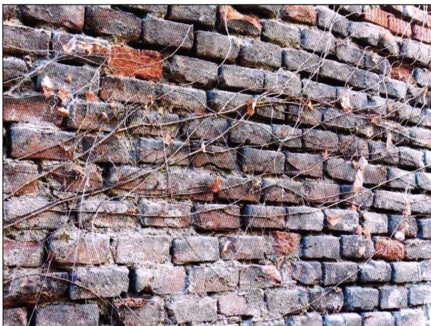
Foto č. 5 – Režné zdivo s vymytou zdicí maltou mezi cihlami.
