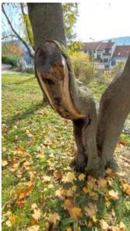
Poškozený kmen vlivem odřezání druhé kosterní větve javoru č. 4
