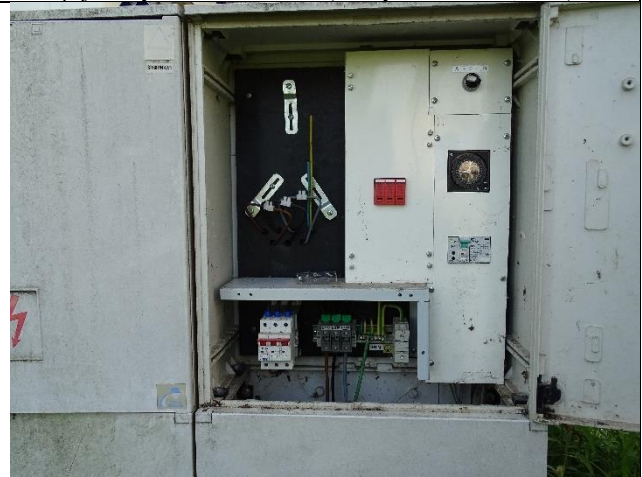
Obr. P3-4 – Celkový pohled do otevřeného rozvaděče – tento rozvaděč bude využit pro napojení podružného elektroměru pro systém VIS Brno (Terezy Novákové 62, Brno)
