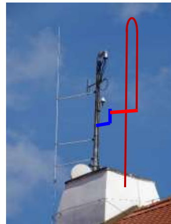
Obr. P1-4 – střecha administrativní budovy, poloha umístění antény VIS°(BO60) přes výložník na volném stožáru, azimut 150°
