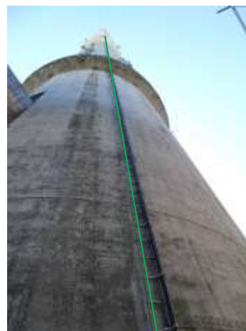
Obr. P2-6 – kabel k anténě ve stávající trase MP (LCFS114-50 JA-A, na příchytky)
