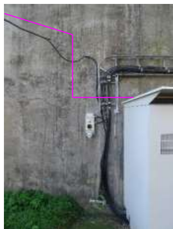
Obr. P2-5 – přívod napájení (kabel CYKY-J 3×2,5, nová trasa po novém závěsu)
