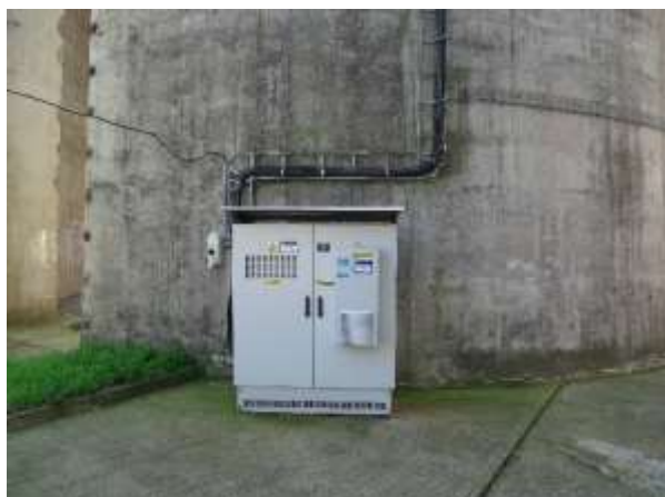
Obr. P2-3 – pata komínu se stávajícím rozvaděčem MP
