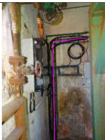
Obr. P2-13 – stávající trasa od průrazu do kabelového kanálu budovy výměníku (kabel CYKY-J 3x2,5 po urovnání doplnit na přichytky)
