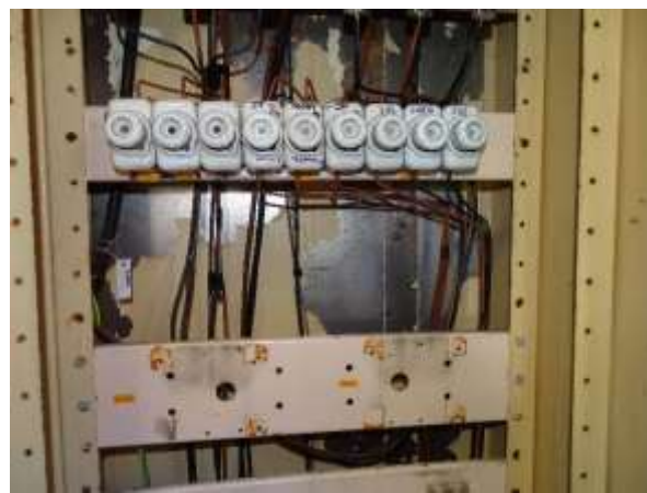
Obr. P2-18 – stávající rozvaděč RM110, pojistky
