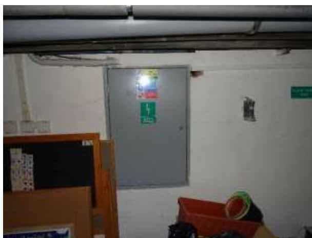
EST.1 – umístění rozvaděče pro napojení sirény v suterénu starší budovy
