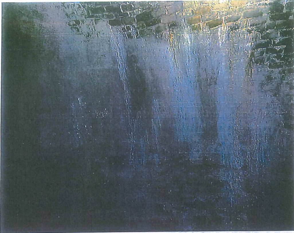
Lokální průsaky zdiva východní stěny
