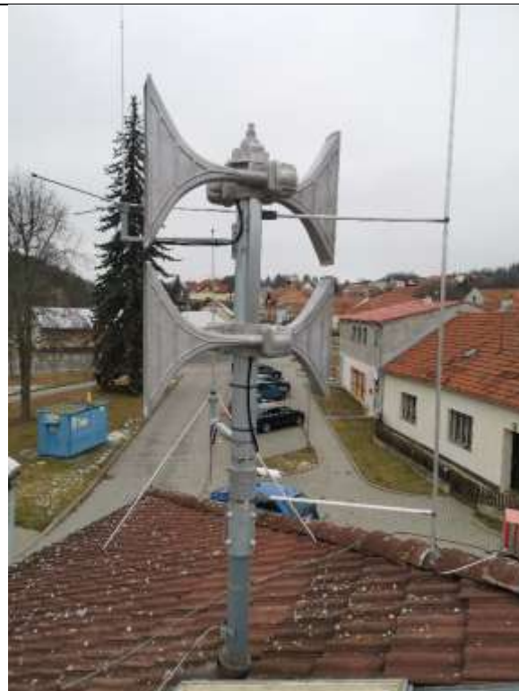
Obr. ESN.7-3 – detail umístění konstrukce s novým stožárem sirény na střeše ÚMČ Jehnice, antény VIS a JSVV, oddálený hromosvod
