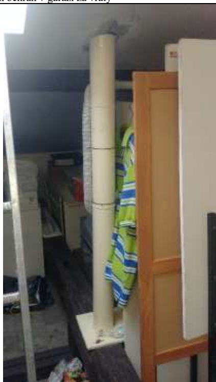
Obr. ESN.7-6 – kotvení spodní části stožáru do konstrukce krovu, trasa kabelů v elektroinstalační trubce
