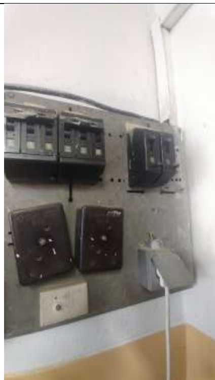
Obr. ESN.7-7 – doplnění stávajícího podružného rozvaděče NN napájení doplněný jističem 10A/B a podružným elektroměrem přívodu
