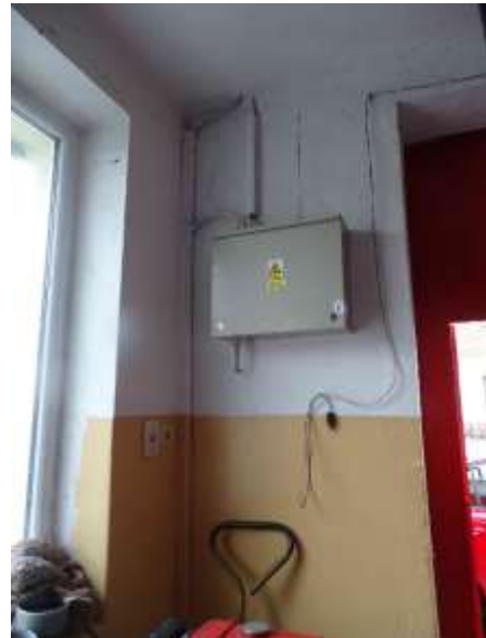
ESN.7 – umístění rozvaděče původní rotační sirény
