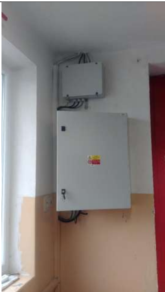
Obr. ESN.7-4 – umístění rozvaděče sirény a krabice přepětových ochran v garáži za vraty
