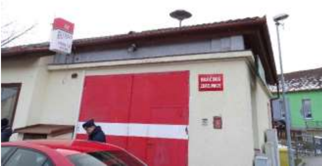
ESN.7 – Původní rotační siréna na střeše objektu ÚMČ
