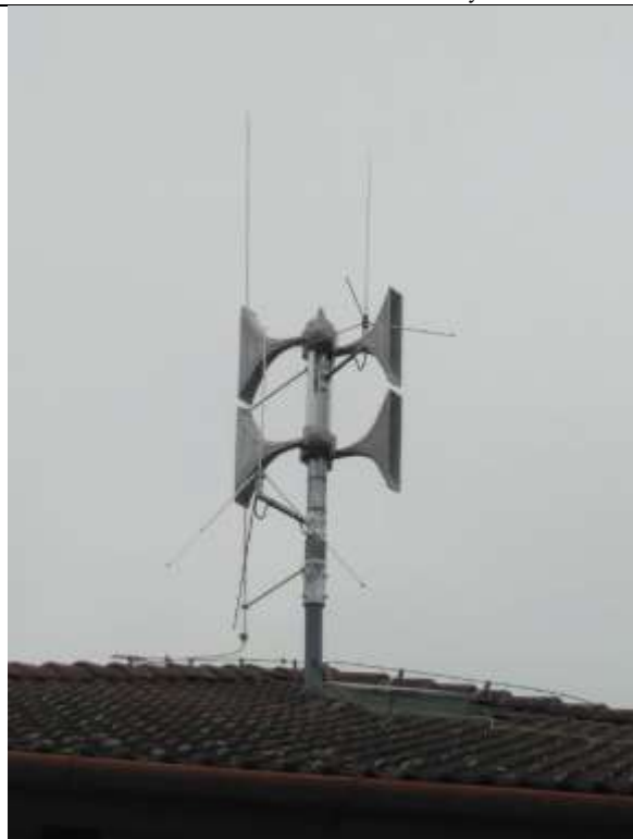
Obr. ESN.7-2 – detail umístění konstrukce s novým stožárem sirény na střeše ÚMČ Jehnice, antény VIS a JSVV, oddálený hromosvod
