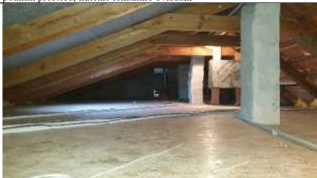
Obr. EST.19-5 – kabelová trasa
