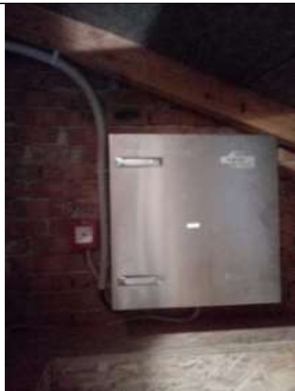
Obr. EST.19-3 – umístění rozvaděče sirény na šítovou zeď v půdním prostoru, tlačítko lokálního ovládání
