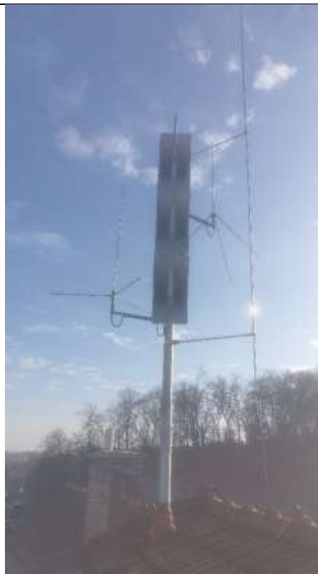
Obr. EST.19-2 – detail stožáru, 6 ozvučnic na novém stožáru, antény VIS a JSVV na výložníku, oddálený jímáč hromosvodu
