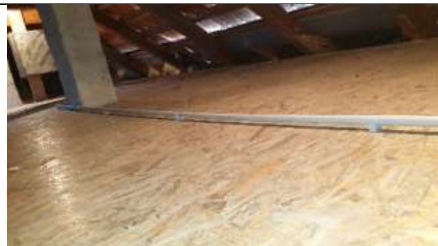
Obr. EST.19-6 – kabelová trasa
