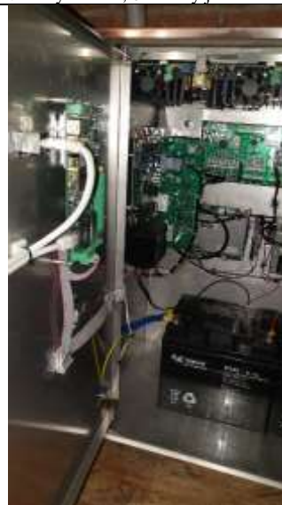
Obr. EST.19-4 – otevřený rozvaděč sirény
