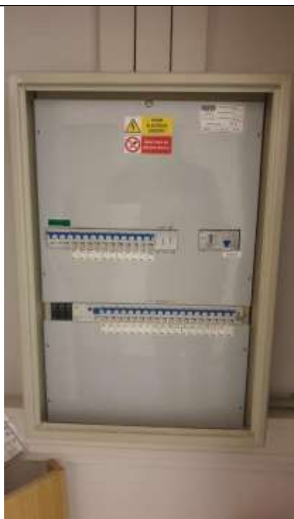
Obr. ES.25-5 – umístění stávajícího rozvaděče NN (patrový 3.NP) – jistiění a podružné měření spotřeby
