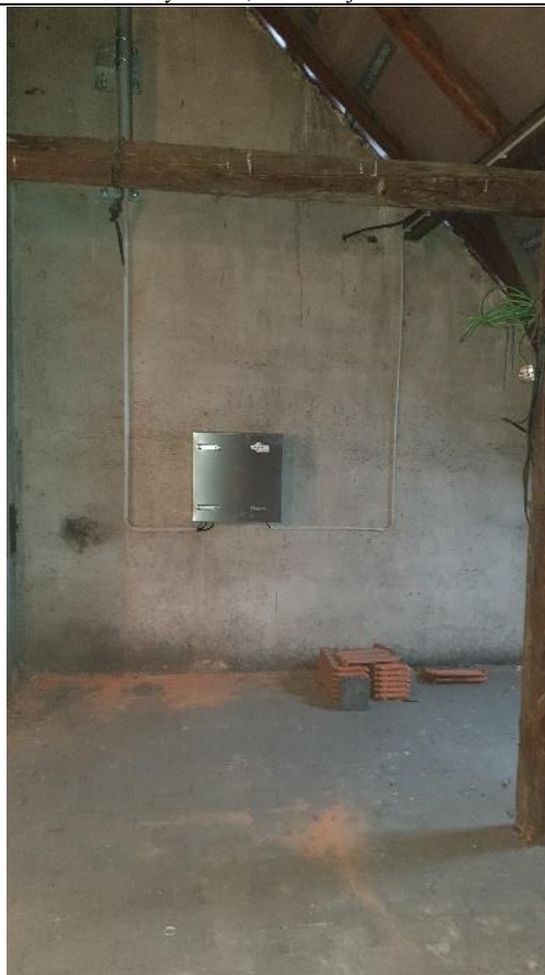
Obr. ES.24-4 – umístění rozvaděče sirény na štitové stěně pod novým stožárem sirény
