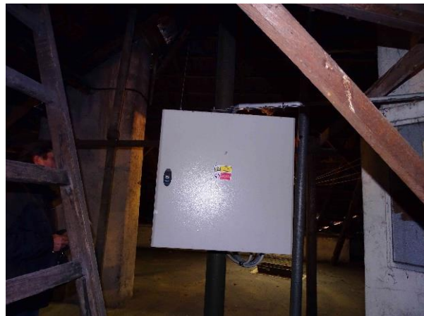
ES.24 – umístění rozvaděče Původní sirény
