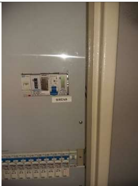
Obr. ES.25-6 – napájecí rozvaděč sirény (patrový 3.NP) – doplnění jistiění a podružné měření spotřeby
