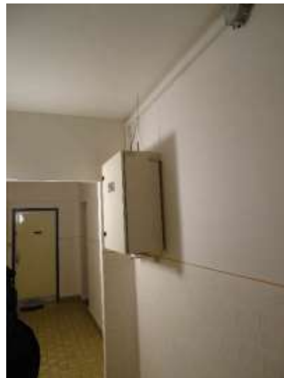
ES.21 – umístění rozvaděče původní sirény
