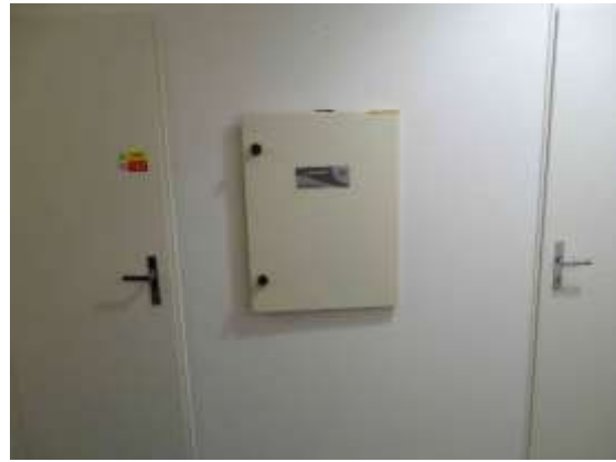
ES.25 – rozvaděč původní sirény na chodbě ÚMČ Židenice
