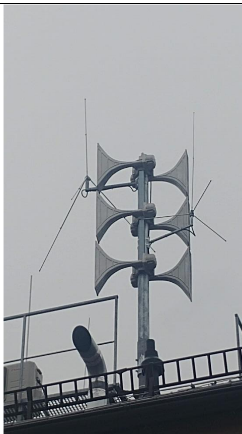
Obr. ESN.6-2 – detail stožáru, 6 ozvučnic na novém stožáru, antény VIS a JSVV na výložníku
