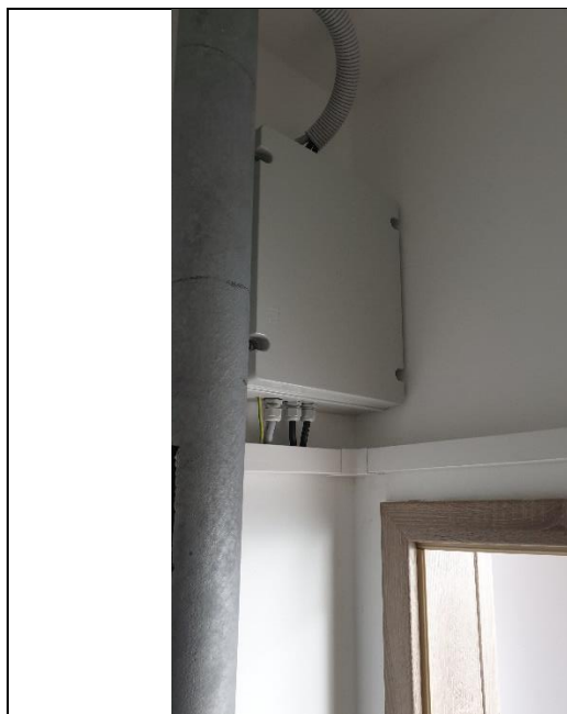
Obr. ESN.6-5 – umístění krabice přepět'ových ochran v kanceláři, tlačítko místního ovládání
