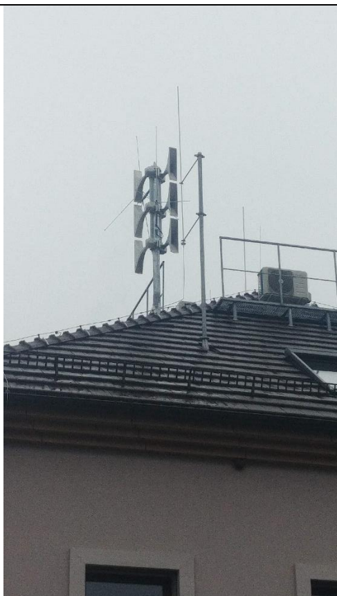
Obr. ESN.6-1 – umístění nové sirény na střeše ÚMČ
