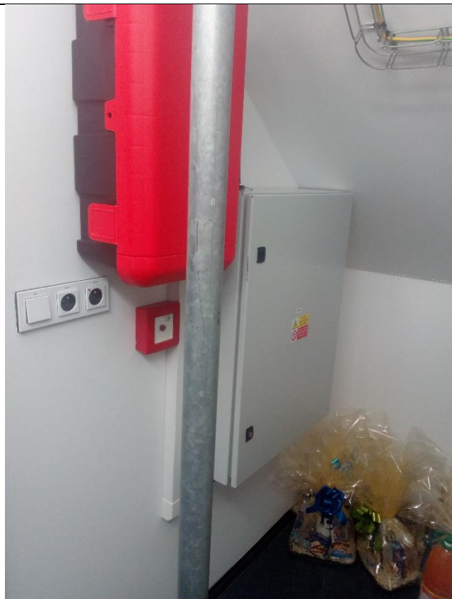
Obr. ESN.6-3 – umístění rozvaděče sirény a tlačítka lokálního spuštění pod stožárem sirény v půdní vestavbě
