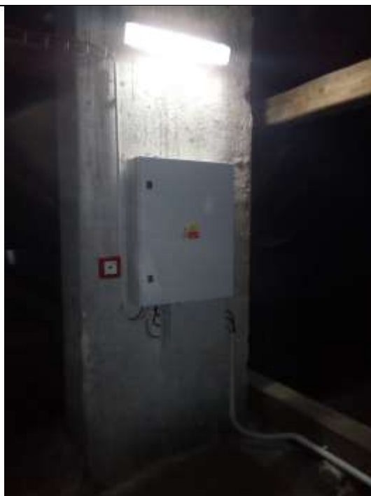
Obr. ESN.10-3 – umístění rozvaděče sirény v půdním prostoru, tlačítko lokálního ovládání
