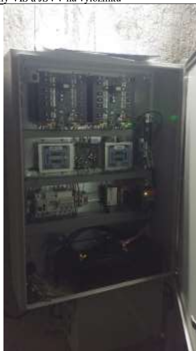
Obr. ESN.10-4 – otevřený rozvaděč sirény
