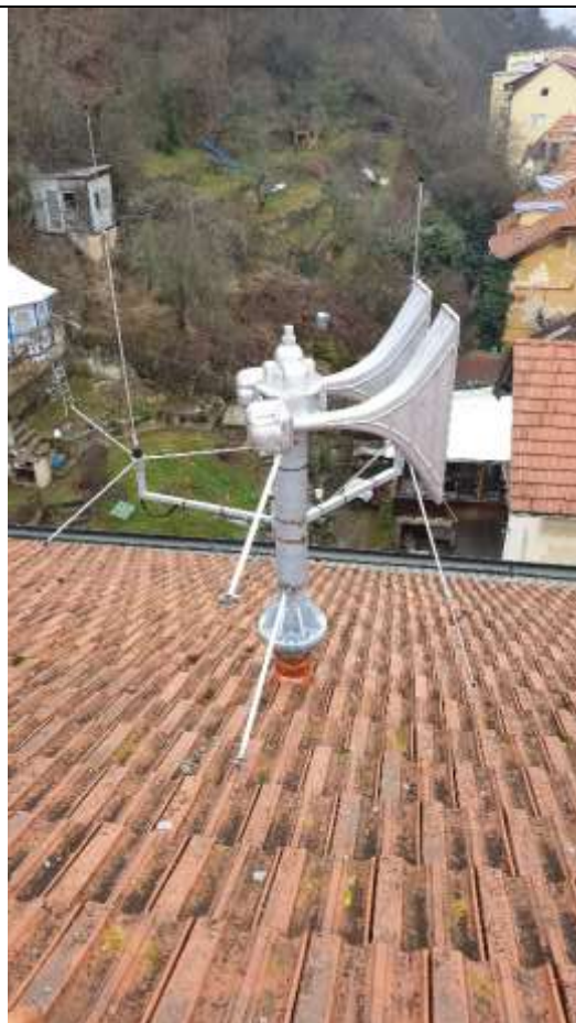
Obr. ESN.10-2 – detail stožáru, 2 ozvučnice na novém stožáru, antény VIS a JSVV na výložníku
